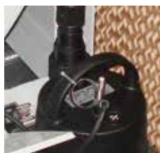
POMPE D'EAU GRUNDFOS AVEC RÉGULATION DU DÉBIT ET SYSTÈME DE DRAINAGE CONTINUÉ POUR ÉVITER LES HAUTES CONCENTRATIONS DE SELS MINÉRAUX.
